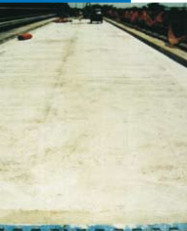
Travée béton reconstituée
