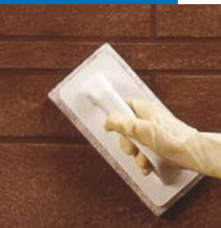
Nettoyage des joints en sol avec le scotch Brite (sur produit partiellement durci)
